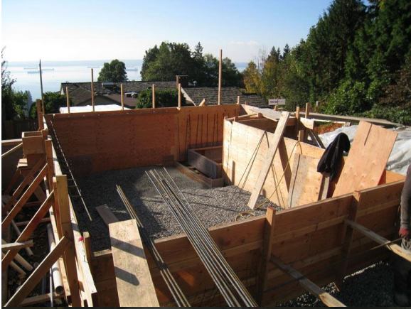
ໄມ້ແປ້ນແບບຂະໜາກໜາ2,5ຊມກວ້າງ20ຊມຍາວຕາມ ການແນະນໍາຂອງວິຊາການ
