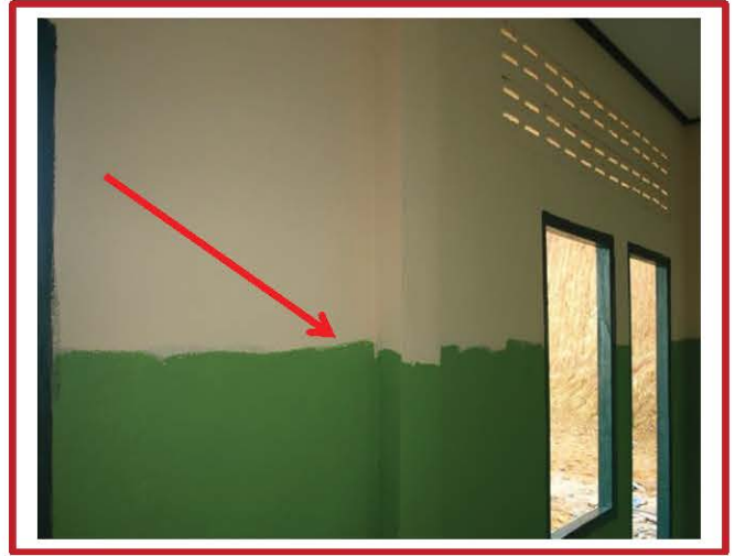
ບໍ່ຄວນທາສີກັນເປື້ອນຄົງແບບນີ້ເດັດຂາດ
