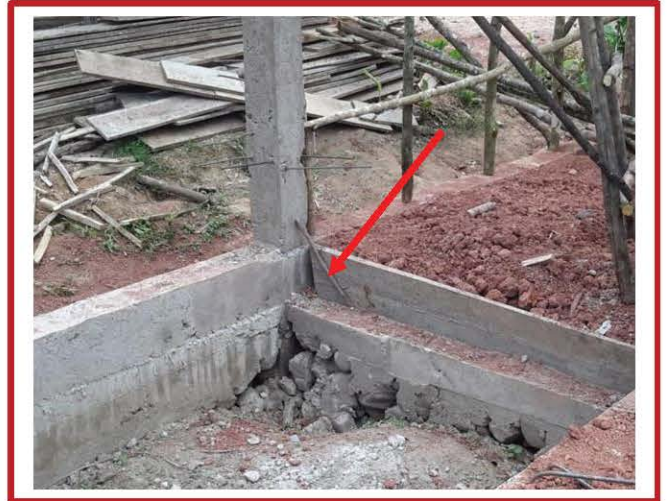
ຝາກໍ່ຝາກັນດິນ ທີ່ບໍ່ໄດ້ມາຕະຖານ (ຝາໂກນ)
