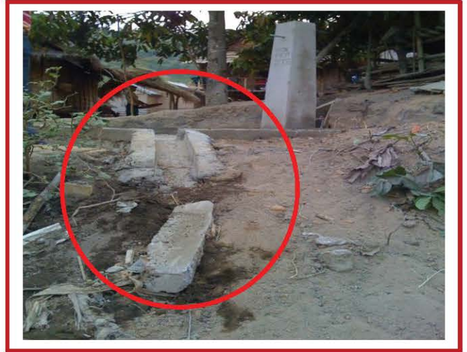
ການສ້າງຮ່ອງລະບາຍນ້ຳເສຍບໍ່ໄດ້ມາດຕະຖານ ບໍ່ໜັ້ນຄົງ
