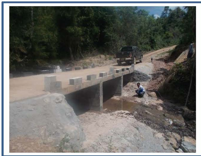
ພາຍຫຼັງສໍາເລັດວຽກຕ້ອງອານາໄມສະຖານທີ່ກໍ່ສ້າງ
