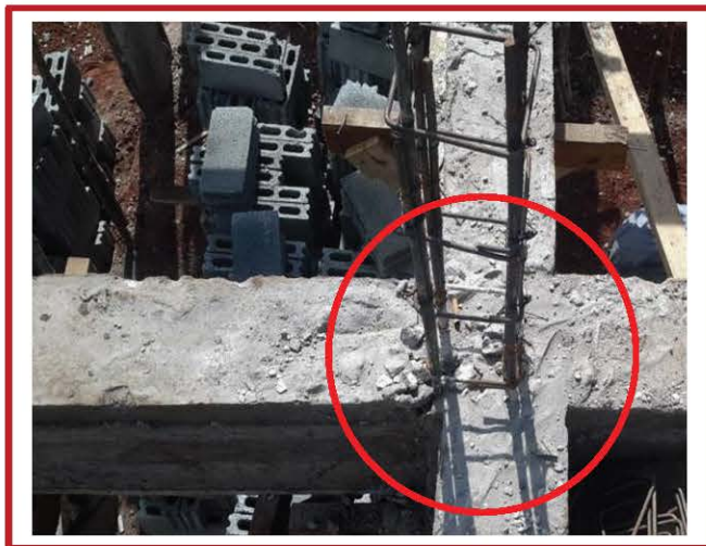
ບໍ່ຄວນວາງເຫລັກເສົາອອກຈາກໃຈກາງຄານ ຖືວ່າຜິດເຕັກນິກ
