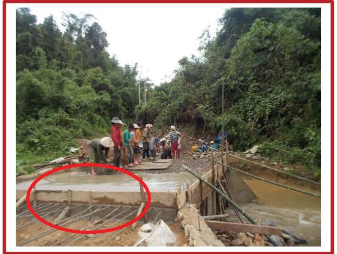
ຫ້າມເດັດຂາດບໍ່ໃຫ້ຈິ່ງເຫລັກຍື່ນອອກມາຈາກເບຕົງ
